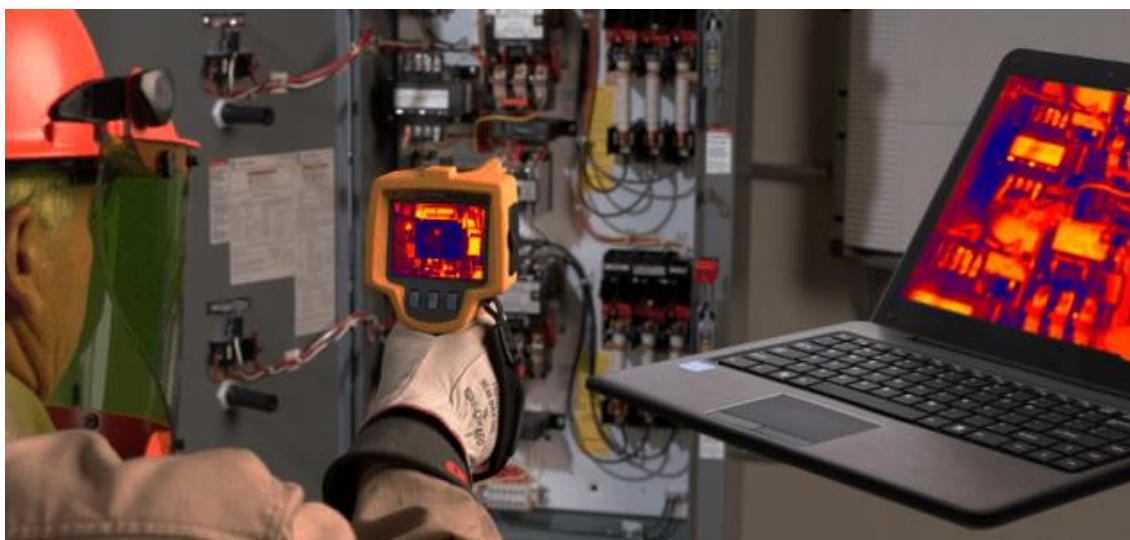
Рисунок 20. Пример проведения тепловизионного контроля электрошкафа
